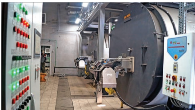
Котлы, с которых на конвертер подается водяной пар
