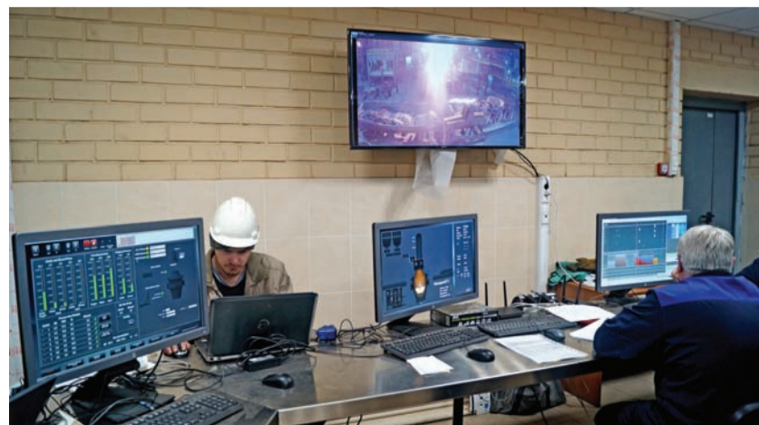
В пультовой комнате конвертера
